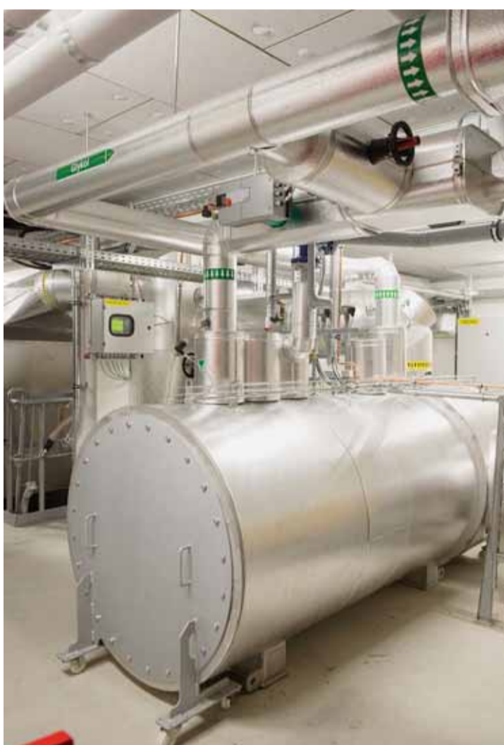
Eines der beiden Herzstücke des sanierten Anlage: Die neue Luftreinigungsanlage im Untergeschoss des Krematoriums.
